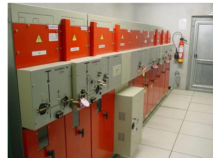
Illustration 12 : Intérieur d'un poste de livraison
